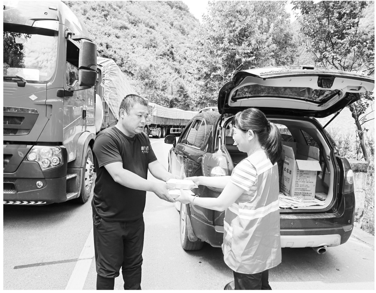
受近期持续强降雨天气影响,镇巴境内国省干线公路发生多处山体滑坡、泥石流等地质灾害。9月5日19时,210国道长滩河段K1685+300处发生山体滑坡自然灾害,100余米道路被掩埋,塌方方量2万5千多方,交通完全中断。灾后,镇巴公路管理段紧急组织展开道路抢通工作,同时成立便民服务小分队,为滞留司乘提供热水和食物。文/图 魏涛
