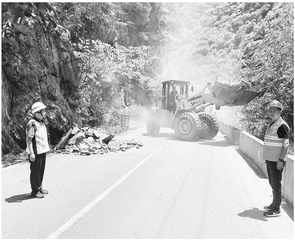
8月1日,周至公路段组织机械和人员,及时清理108国道秦岭山区K1424+300至1500+100段路面小型塌方、泥石流和零星100余处,约1494立方米,确保群众出行安全和畅通。文 / 图 杨萍 程冰
