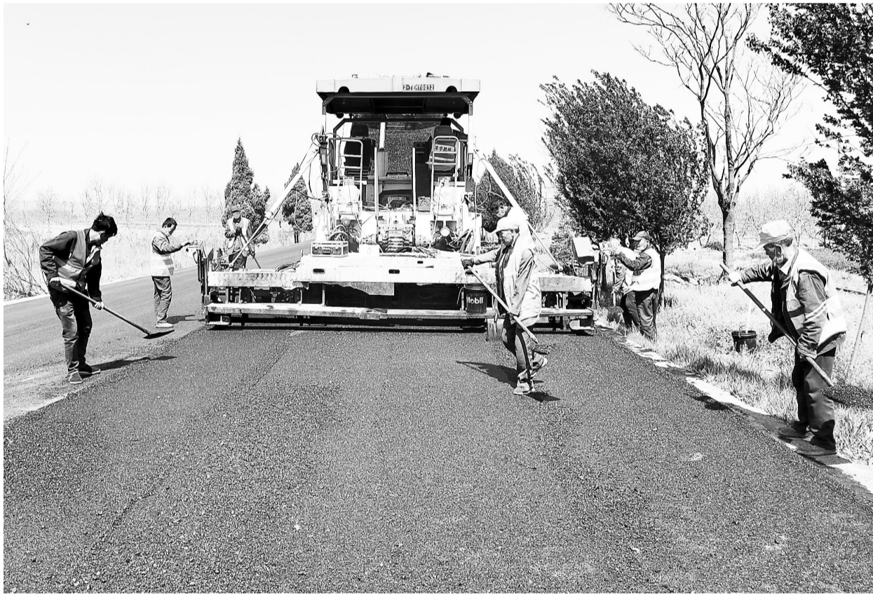
为确保车辆通行安全,近日,合阳公路管理段对辖区沉陷路面进行现场勘查,分析原因,按照《路基路面施工技术规范》要求集中整治,严把工程质量关,营造“畅、安、舒、美”的道路通行环境。文/图 党洪峰
